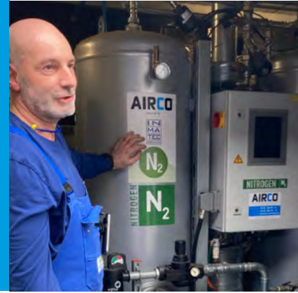
Foto oben: Werkseigene Stickstoffherstellung bei der CBV Blechbearbeitung GmbH, Laasdorf. Die Produktion vor Ort erfolgt bedarfsgerecht und vermeidet Transportaufwand.
