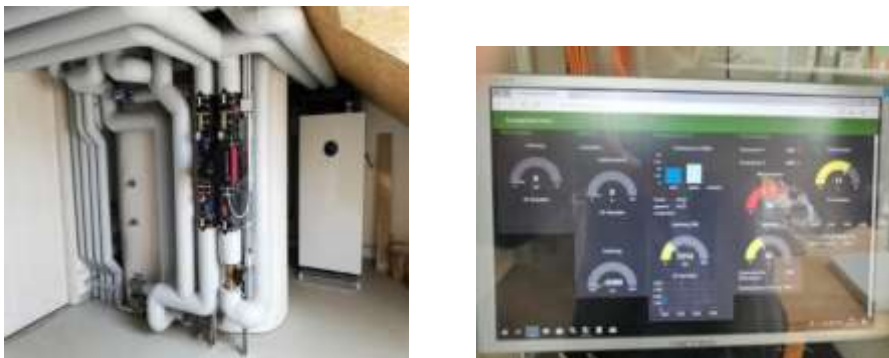
Abbildung 3: Heizzentrale mit Steuerungseinheit (rechtes Bild)
